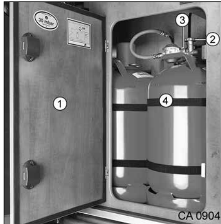
Fig. 46 Coffre à gaz
