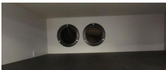
Bouche de ventilation de l'air froid
