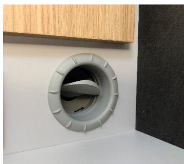
Bouche de sortie d'air chaud
