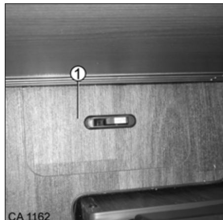
Fig. 104 Emplacement de la vanne de sectionnement de l'échangeur thermique Iveco
