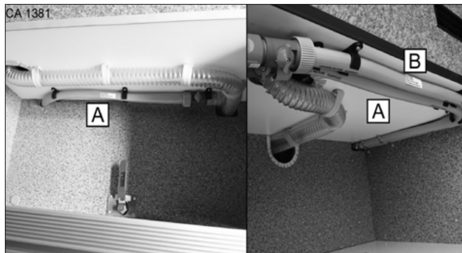
Fig. 135 Tuyau de rinçage Fiat/Tuyaux de rinçage Iveco
