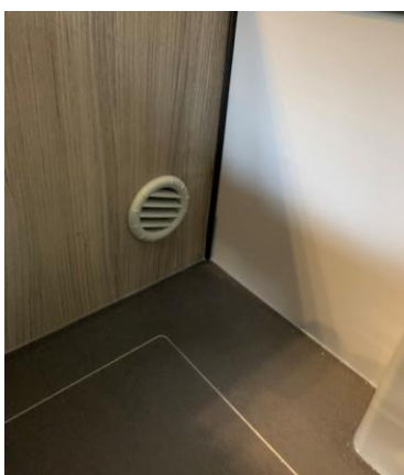
Bouche de ventilation de l'air chaud
