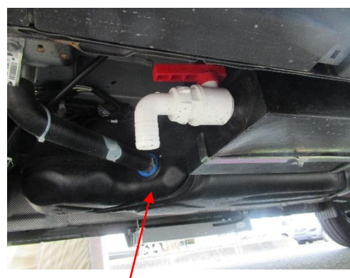
Robinet de vidange du réservoir des eaux usées
