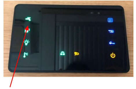
Bouton de mise sous tension de la pompe
