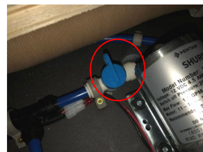
Vanne de vidange d'eaux
