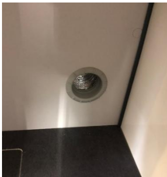
Bouche de ventilation de l'air chaud
