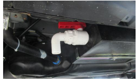
Robinet de vidange du réservoir des eaux usées
