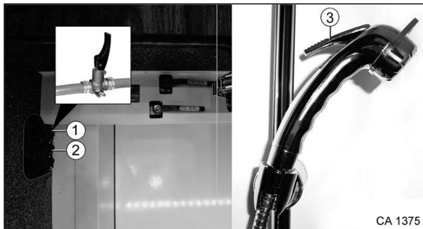
Afb. 165 Aftapkraan van de boiler/douchekop
