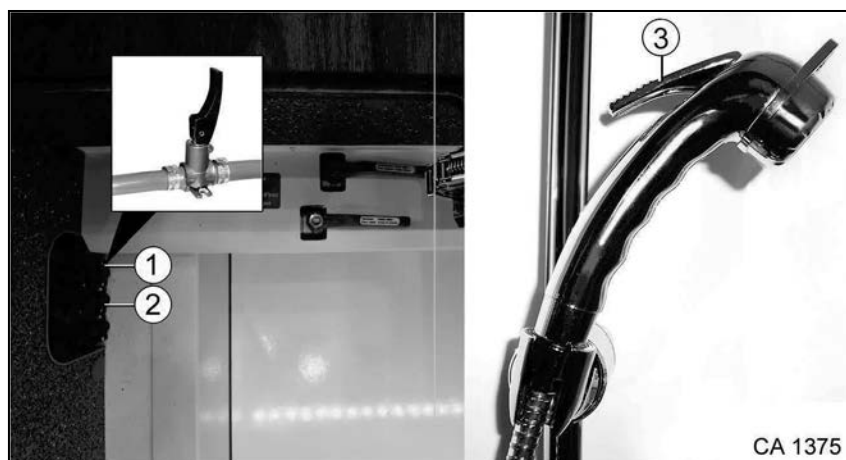
Afb. 166 Aftapkraan van de boiler/douchekop
