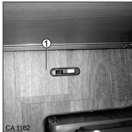
Afb. 141 Positie afsluitventiel warmtewisselaar Iveco
