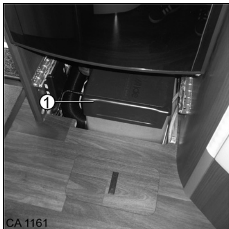
Fig. 137 Emplacement du chauffage
