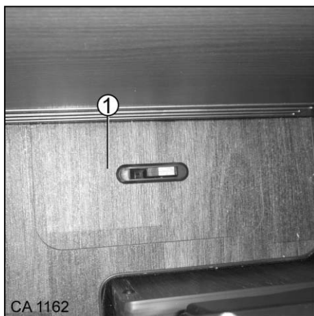
Fig. 132 Emplacement du robinet d'arrêt de l'échangeur thermique Iveco
