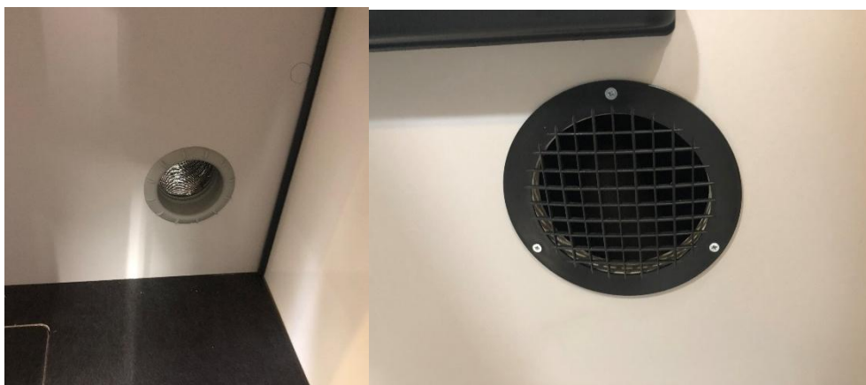
Bouche de ventilation de l'air chaud
