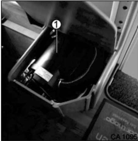
Fig. 118 Chauffage à l'air pulsé
