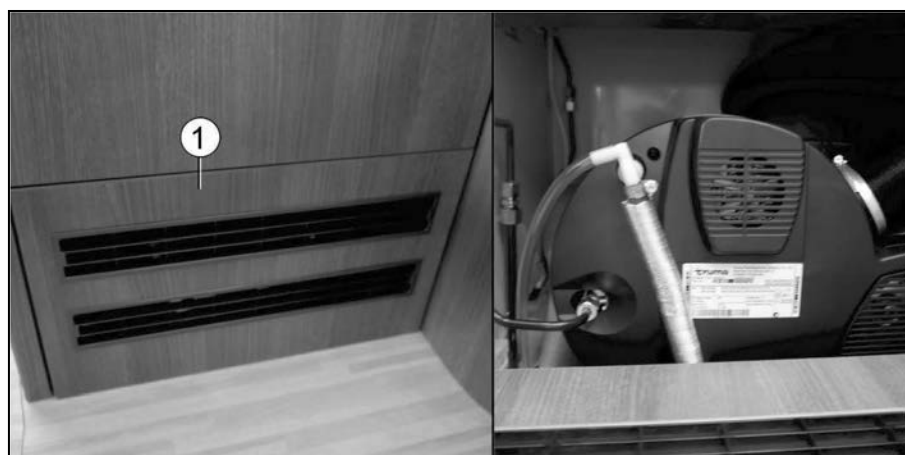
Fig. 120 Chauffage sous la penderie
