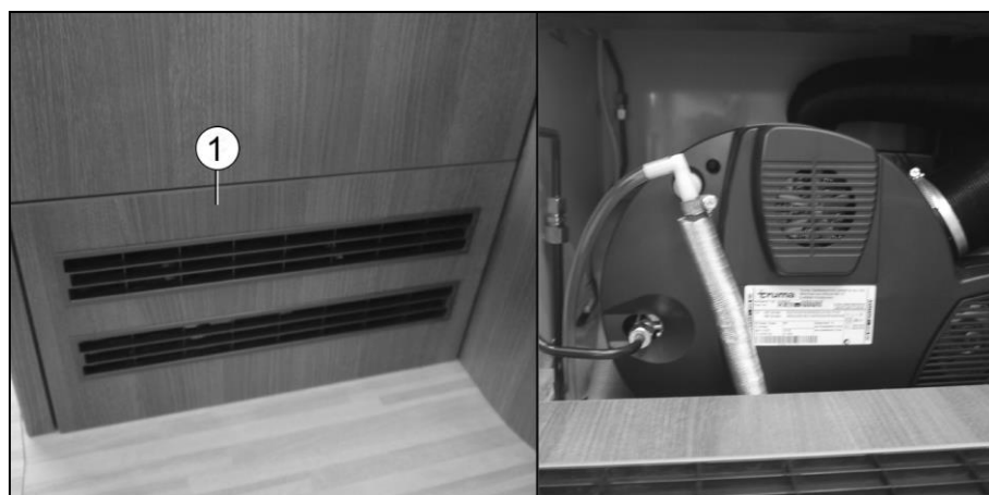
Fig. 115 Chauffage sous la penderie
