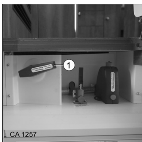
Fig. 148 Vidange du réservoir des eaux usées
