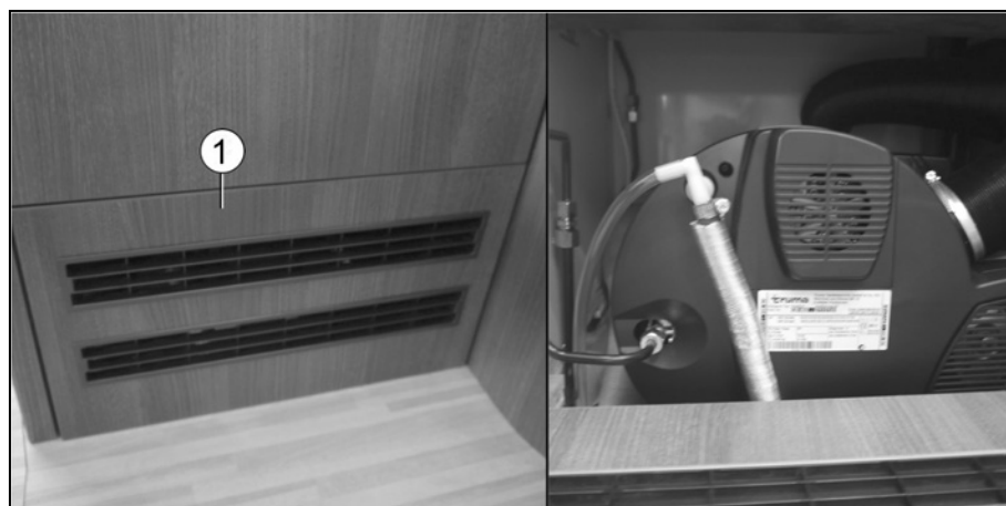
Fig. 119 Chauffage sous la penderie
