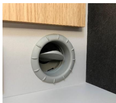
Bouche de sortie d'air chaud
