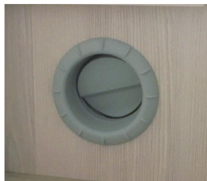
Bouche de ventilation de l'air chaud
