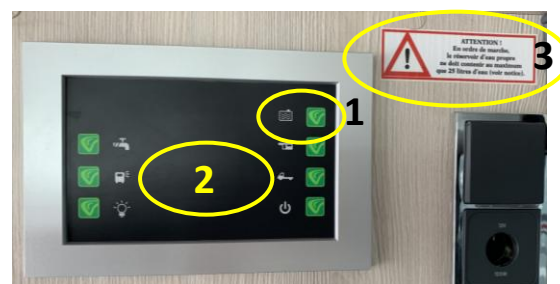
Vue panneau d'affichage remplissage en eau propre
