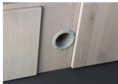
Bouche de ventilation de l'air chaud
